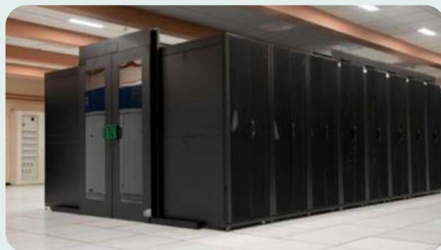
Baies de la DSI de l'UM en SM3
