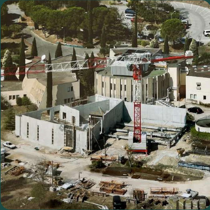
Le CINES d'hier avant la construction de la salle machine 5
